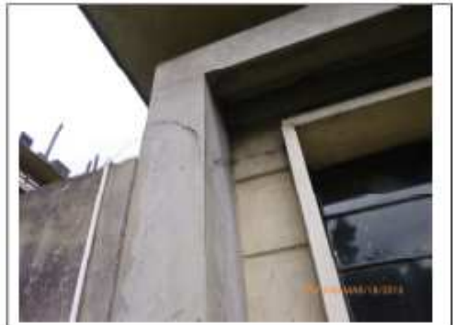
Foto 4 : ALGUNOS ELEMENTOS ESTRUCTURALES COMO ESTA COLUMNA PRESENTAN GRIETAS Y SE VE TAMBIEN EN EL MURO
