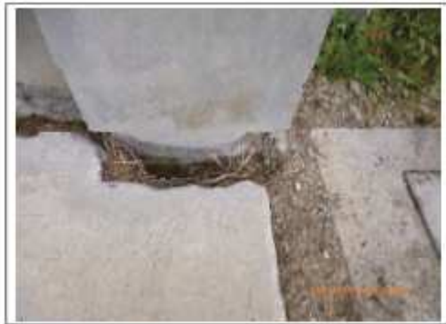
Foto 4: GRIETAS ENTRE LA ESTRUCTURA Y ANDENES PERIMETRALES
