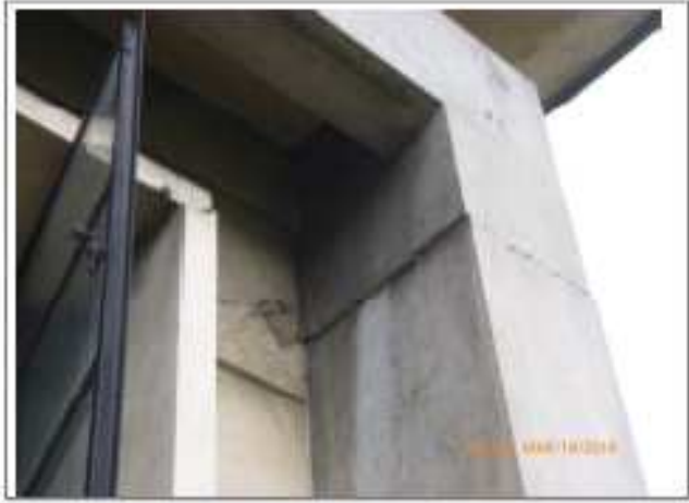
Foto 2: FISURAS EN ALGUNOS ELEMENTOS ESTRUCTURALES BLOQUE 2
